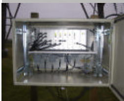
Monitoring de câbles
