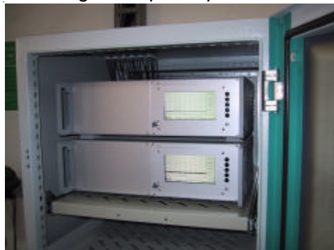
Système de monitoring dans un poste 123kV
