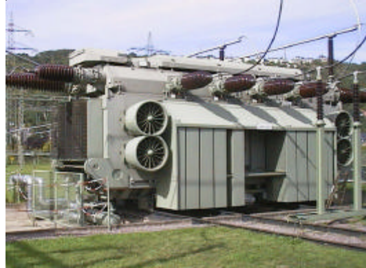
Transformateur 110/220 kV RWE
