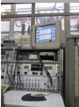
Salle de contrôle
