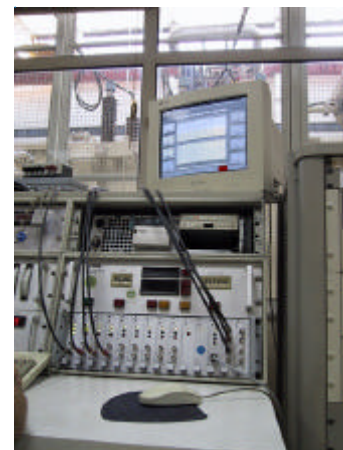
ICMsys8 dans une salle de contrôle
