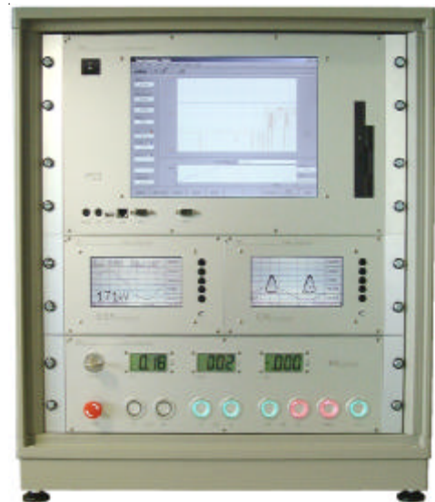
Système de contrôle et de mesure
